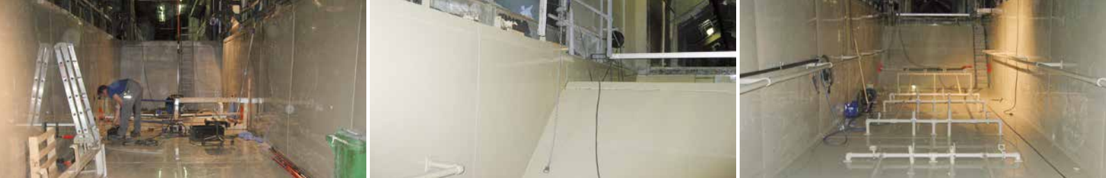
V. l. n. r.: Einbau der SIMONA® PP AlphaPlus® Auskleidung in die KTL-Wanne; Überlauf der KTL-Wanne; Einbau der Düsenrohre.
